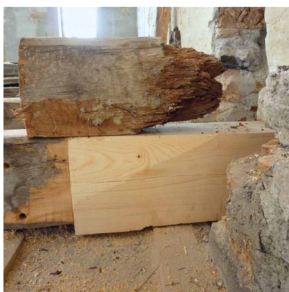
Ansicht einer ausgeführten Überblattung mit darüber liegendem originale zersticktem Holzbalkenkopf
