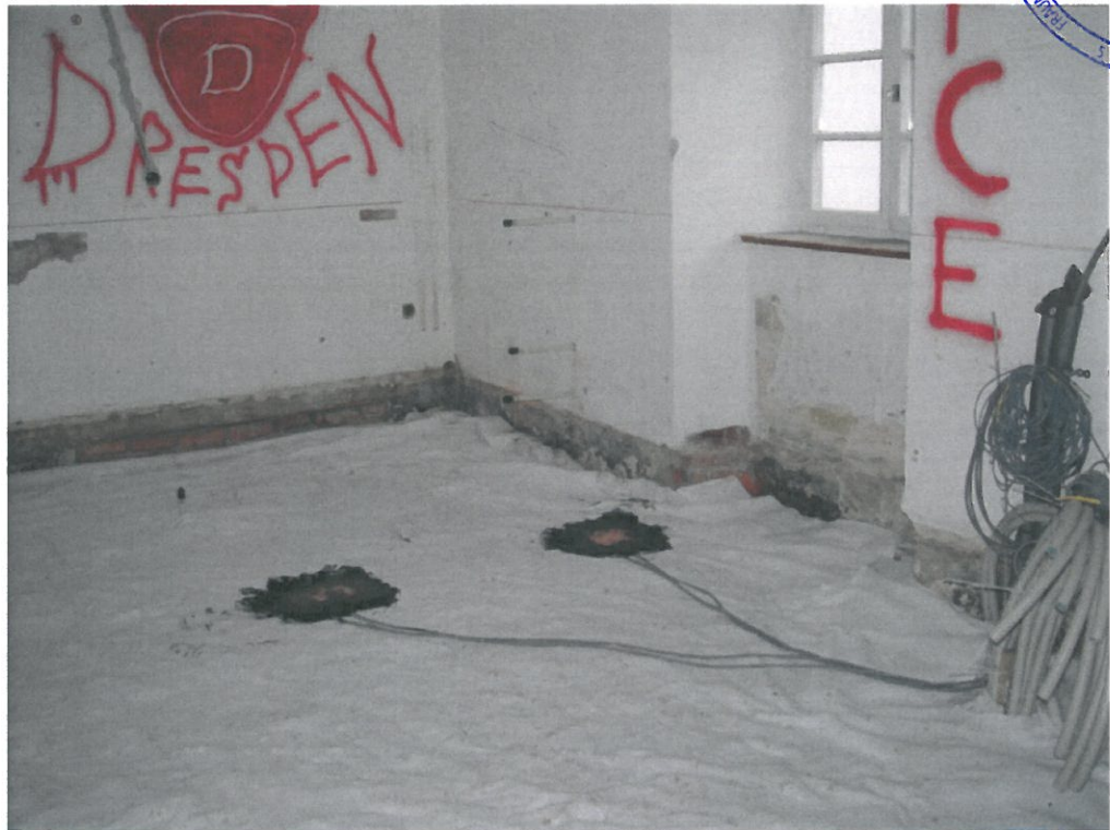
Bild 9: Installation der mit Kupferplatten geschützten Wärmestrommessscheiben und Temperatursensoren in Mitte und Randbereich des Raumes.
