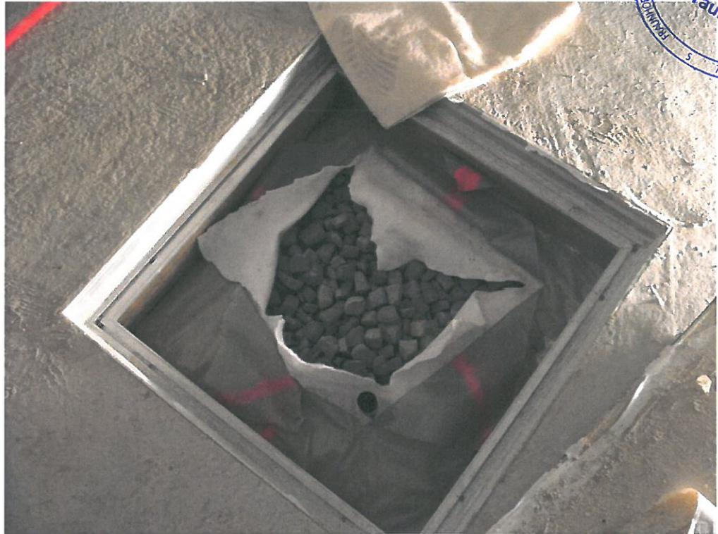
Bild 14: Inspektionsluke im Boden mit Folie und Vliesabdeckung des darunterliegenden Glasschaumgranulates im Gebäudeinneren.
