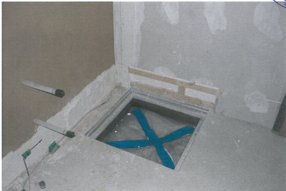
Bild 16: Oben: Revisionsöffnung in Raummitte, fotografiert bei der Entnahme am 12. Mai 2014. Unten: Revisionsöffnung in Raumecke.
