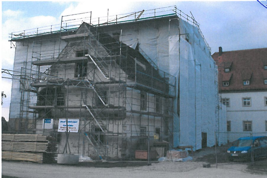
Bild 1: Ansichten »Kloster Benediktbeuern«. Oben: Hauptgebäude des Klosters. Unten: Nebengebäude, das im Rahmen des Projektes »Energetische Altbausanierung und Denkmalpflege »Kloster Benediktbeuern« saniert wird.
