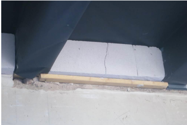
Bild 32: Detailansicht der Geschosdecke von unten (EG) mit Wandanschlussdämmung aus Mineraldämmplatten zwischen den Deckenbalken.
