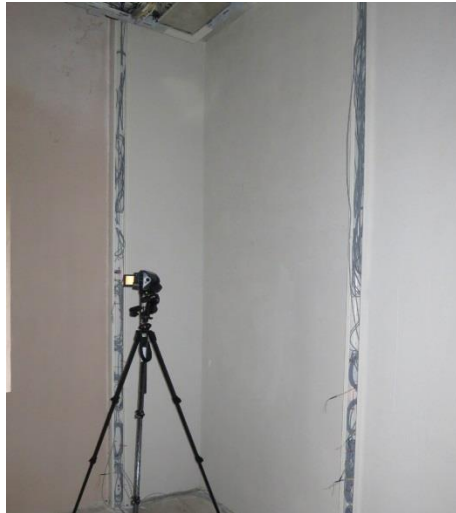
Bild 112: Hochaufgelöste IR-Aufnahme der Wandecke. Aufnahme am 4. März 2014, Temperatur außen 3,6 °C, Temperatur innen 21,3 °C.
