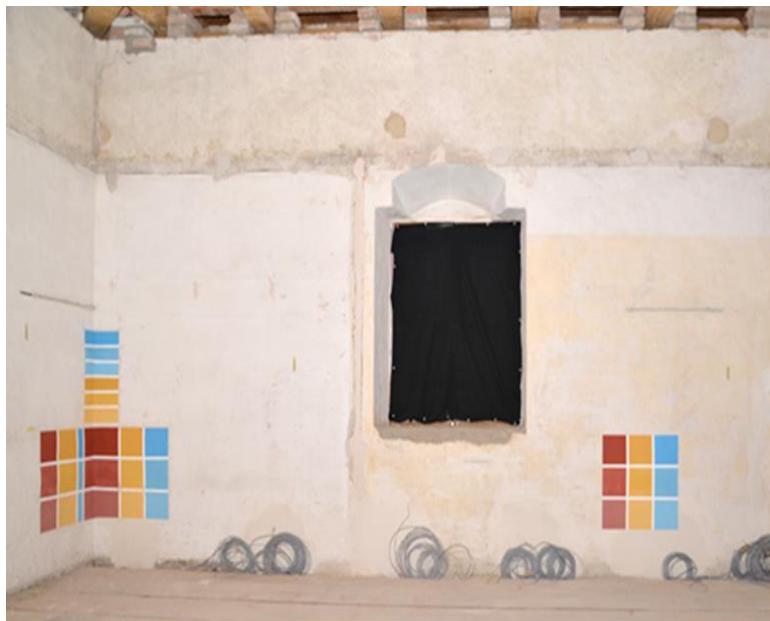
Bild 169: Wandansicht mit Testfarbfelder zur Überprüfung der Reversibilität an Feld 12 und 13, vor Einbau der Innendämmungen.
