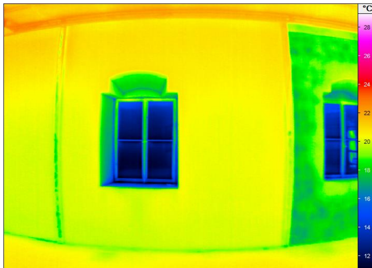
Bild 109: IR-Aufnahme fertig erstellter Innendämmung mit Mineraldämmplatten, Auf- nahme vom 4. März 2014, Temperatur außen 3,6 °C, Temperatur innen 21,3 °C.
