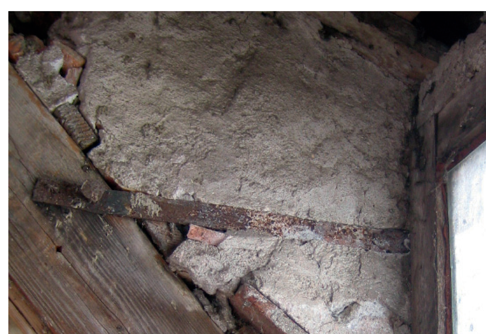
Die Innen- und Außen-seiten der Backenflächen waren ursprünglich verputzt und weiß getüncht. Außerdem waren die Kanten des Fensterstocks mit eingeputzt und zusätzlich durch Eisenbänder fixiert. Die darunter liegende Ziegelkonstruktion waren direkt auf die Dachziegel gesetzt.
